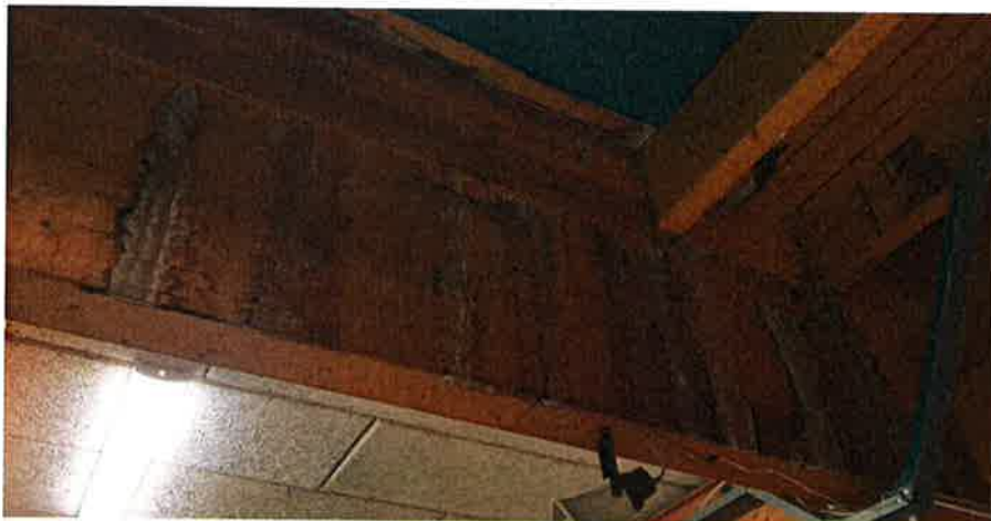
Vatten från taket/väggen har runnit längs limträbalken
