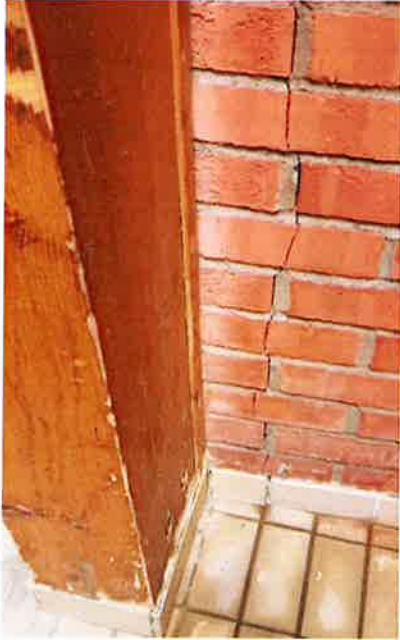
Spricka till följd av trolig sättning
