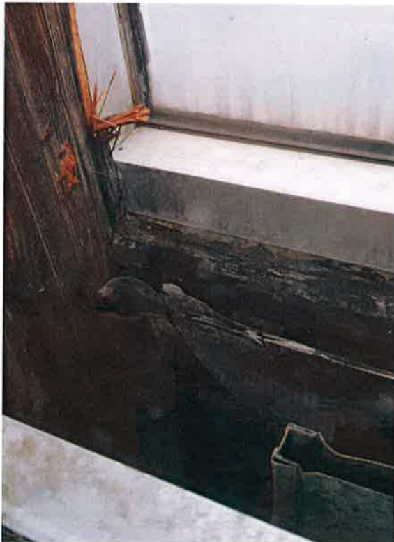
Skadade lättväggpartier i entresoldelen
