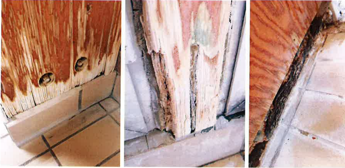
Rötskadade pelarfötter och rostig fotplåt
